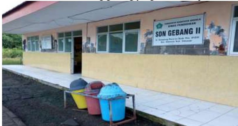
Gambar 2. Dinding gedung yang sudah keropos
