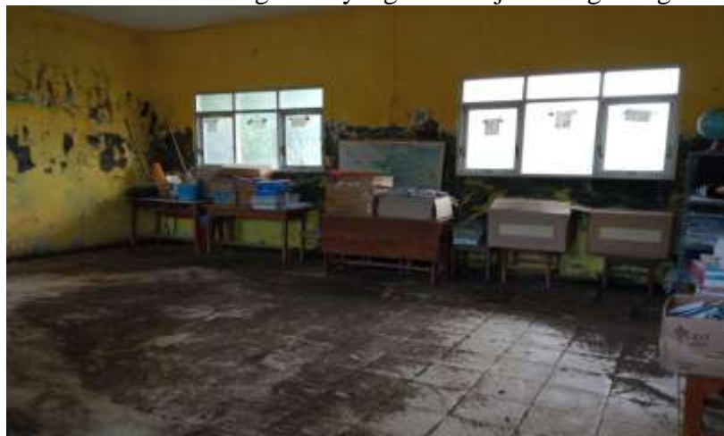
Gambar 3. Ruang kelas yang rusak dijadikan gudang
